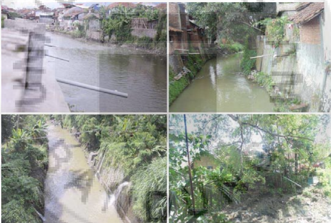
Gambar 1.7 Kondisi Miskin Saluran Pembuangan Air Kotor Sumber : Hasil Observasi, 2015
