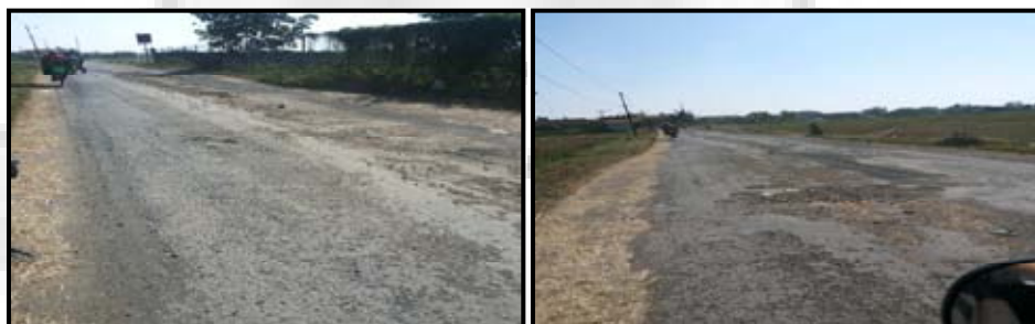
Gambar 4.6 Kondisi Jalan yang Terdapat di TPI Dadap
