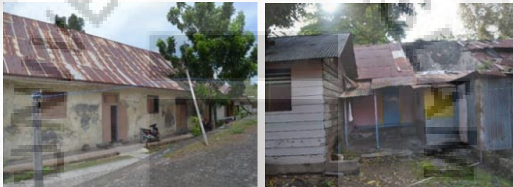
Gambar 1.6 Kerusakan bangunan cagar budaya karena sebagai pemukiman warga (Tampak depan) Sumber : Hasil Survey 2014
