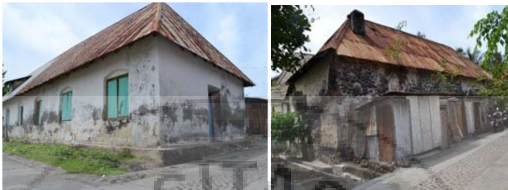
Gambar 1.5 Kerusakan dinding Bangunan cagar budaya yang terdapat dalam benteng Oranje Sumber : Hasil Survey 2014
