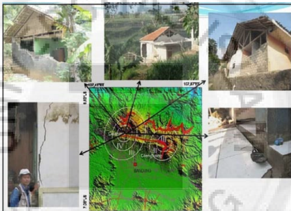
Gambar 1.7 Kerusakan Rumah akibat Gempa Bumi Sesar Lembang di Kecamatan Cisarua pada tanggal 11 Agustus 2011 (Sumber : Badan Penanggulangan Bencana Daerah Kab.Bandung Barat)
