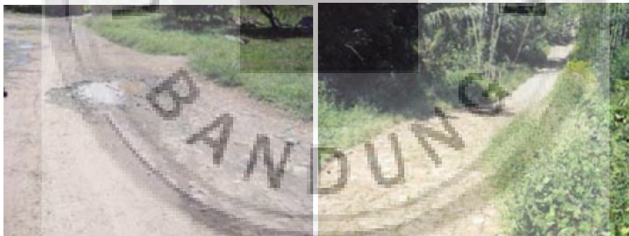
Gambar 1.4 Kondisi Jalan di Kawasan Reok (sumber : Hasil Survey Lapangan, 2015)
